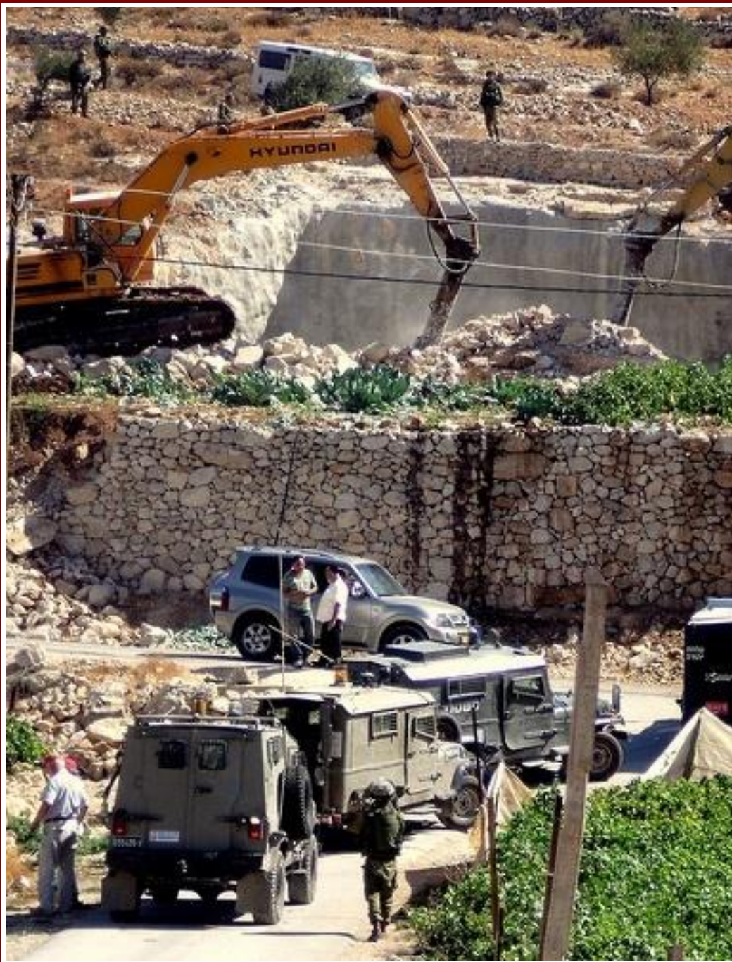
Demolizione di una cisterna sotterranea per l'acqua a al Baqa a nord di Hebron il 03.09.2009
