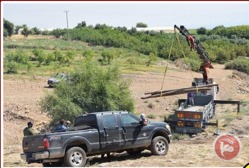
Confisca tubazioni per l'acqua, 5.7.18 Villaggio Bardalla, Cisgiordania, valle del Giordano
